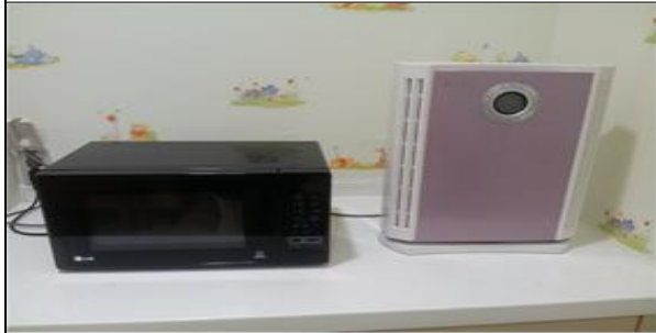
모니터링 장소 : 홈플러스 문화점 사진 설명 : 분리된 수유실 내부에 설치되어 있는 전자렌지와 공기정정기, 둘 다 기저귀 교환대나 휴게공간에 있어야 할 물건인 것 같음.
