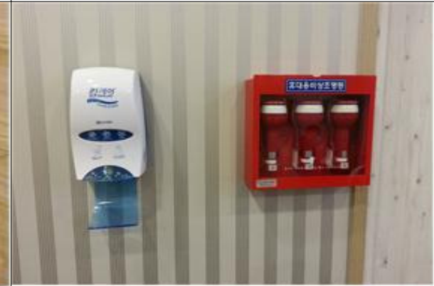
모니터링 장소 : 출입구 옆 손소독기 및 휴대용 비상조명등 사진 설명 : 화재 등의 경우 건물 특성상 천장에 화재감지기, 스프링클러 등이 설치되어있었고, 입구 옆에 손소독기와 휴대용 비상조명등이 비치되어 있었음
