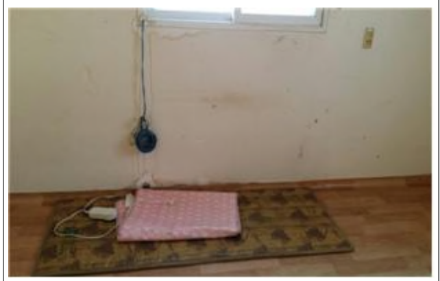
옥상 가건물에 위치한 여성 숙소 누수로 얼룩진 벽지와 지저분한 침구
