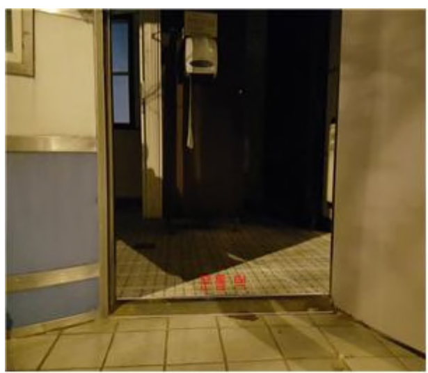
↑장애인 화장실 출입문턱 있음
