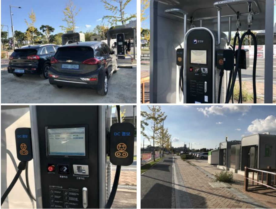
[그림 4-8] 세종호수공원 제2주차장 충전소 현장
