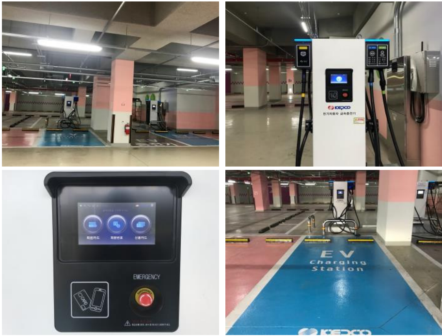
[그림 4-11] 첫마을 BRT 환승주차장 A 주차장 충전소 현장
