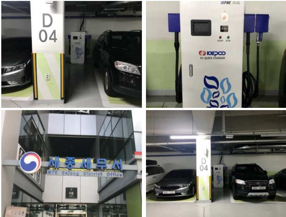
[그림 4-10] 세종세무서 지하1층 주차장 충전소 현장
