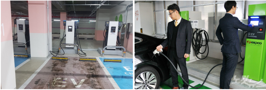
[그림 2-5] 세종시 BRT 환승주차장 충전소(좌), 대구시 롯데백화점 주차장 충전소(우)
