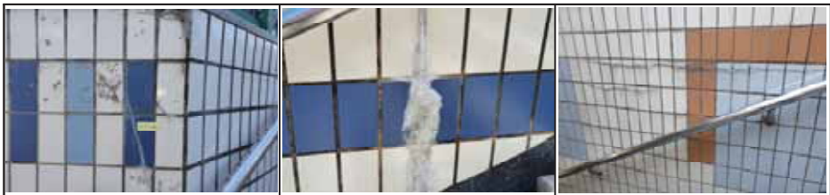
[그림 4-6] 중앙로지하상가의 노후화된 출입구의 타일
