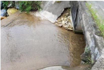
하류의 파손된 교량
