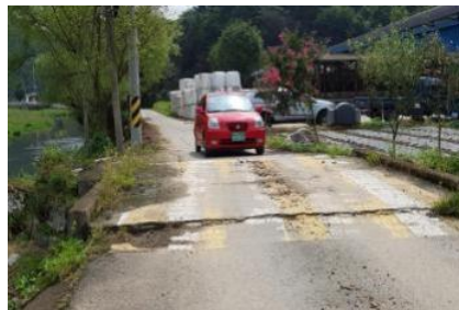
하류의 파손된 도로
