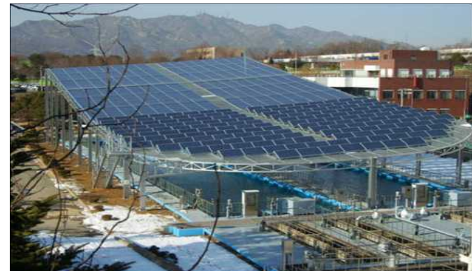
<그림 22> 맑은물 사업소에 설치된 태양광 발전소
