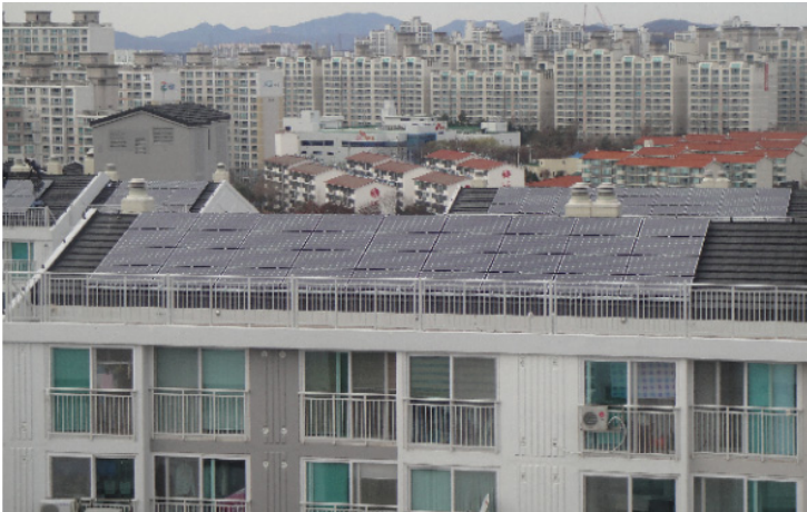
[그림 4-2] LH국민임대 아파트에 설치된 태양광 패널 (건설경제, 2017.03.10.)
