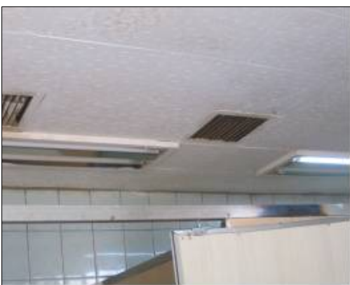
형광등이 한 개만 들어오는 화장실
