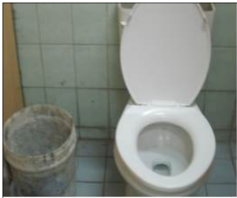
청결하지 못한 화장실
