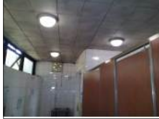
화장실실내등의 친환경센서등 부재
