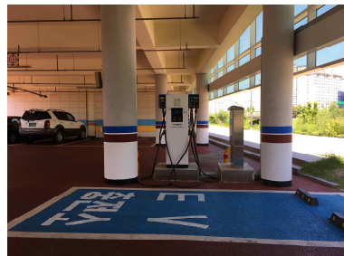
[그림 3-16] 대전시립박물관 전기차(EV) 충전시설 전경
