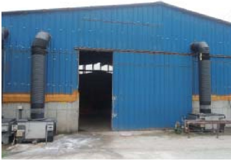
〈퇴비사에 설치된 바이오필터〉
