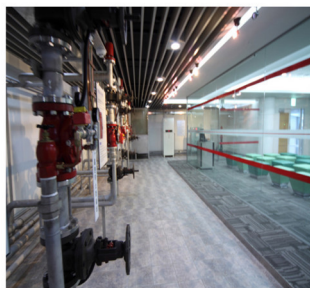
자동화재탐지설비, 스프링클러등 전문소방시설 교육
