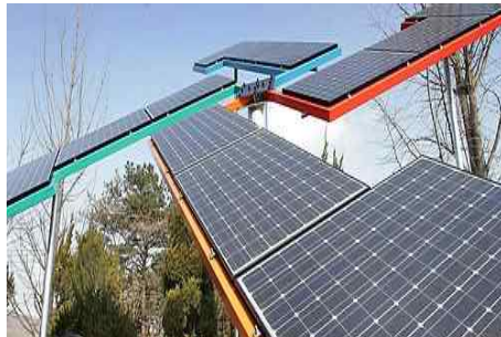
〈그림 5-4〉 대전시 동구, 태양광 발전설비
