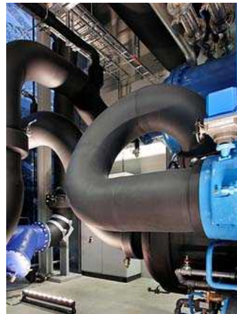
<그림 5-12> 네덜란드, 암스테르담에 설치된 냉방 네트워크의 파이프
