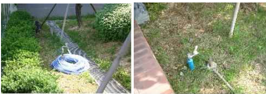
빗물이용시설 수도전 빗물이용시설 수도전
