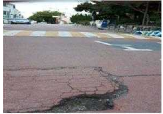
모니터링 장소 : 탄방동 천성교회 부근 사진 설명 : 노면이 파손되어 밤길 보행자의 안전사고 발생 우려가 있음
